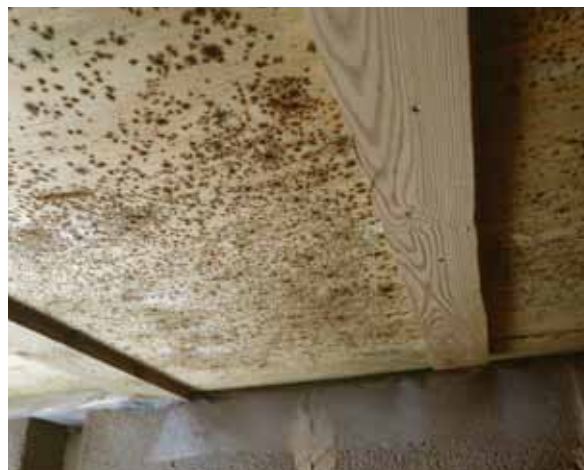
Mögeltillväxt på blindbotten i villa byggd 1991.
